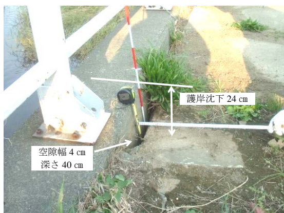
写真-4.3.6 翼壁背後の空隙の計測
