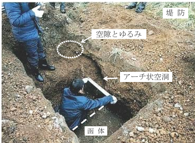
写真-5.2.29 パイピング痕跡
