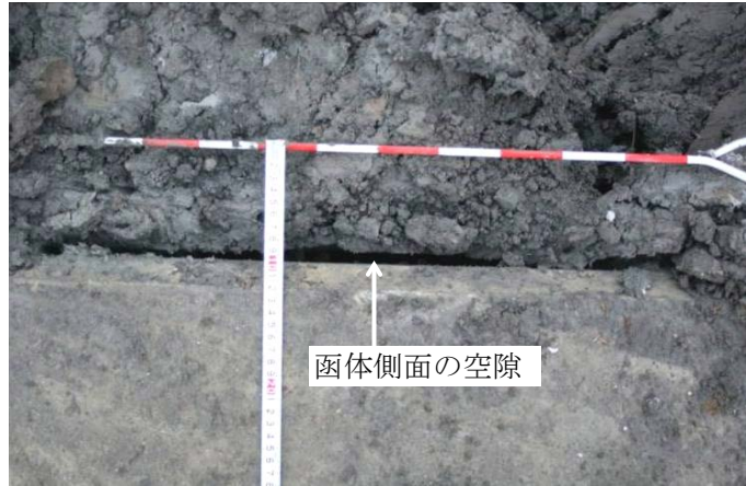
写真-5.2.20 函体上流側の空隙状況 上流側の函体側面と土層の接続部に1.0~2.0cmの空隙が発現した。
