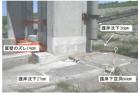
写真-5.2.4 門柱・翼壁周辺の変状
