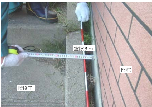
写真-5.2.5 法面中段の門柱横の空隙
