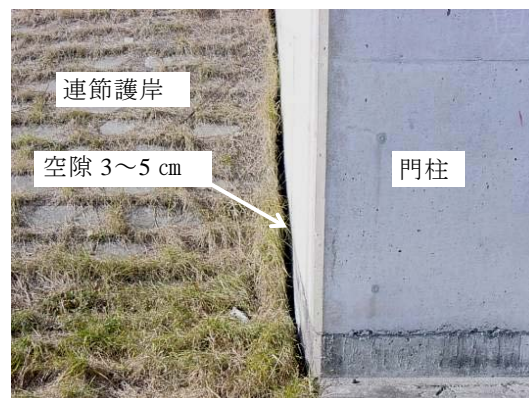
写真-5.2.23 門柱側方の空隙 地震と地盤沈下により、門柱側方に幅3～5 cmの連続的な空隙が発現した。
