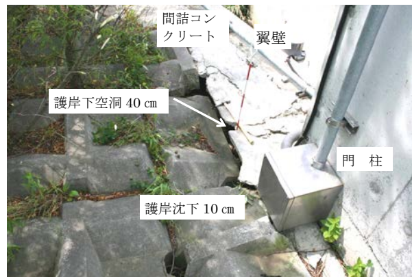
写真-5.2.16 門柱・翼壁周辺の護岸の変状
