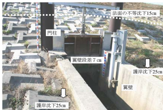
写真-5.2.11 門柱・翼壁周辺の変状
