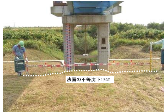
写真-5.2.12 門柱背後法面の不等沈下
