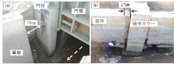
写真-5.2.25 門柱と翼壁の分離および継手損壊
