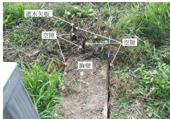
写真-5.2.6 胸壁と遮水矢板周囲の空隙
