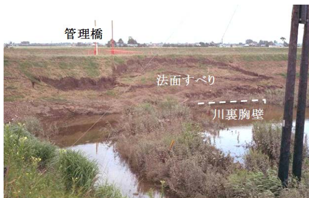
写真-5.2.30 樋門川裏の法面すべり 樋門川裏法肩から法面すべりが発現し、胸壁は埋没した。
