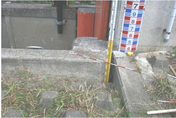
写真-5.2.3 胸・翼壁周辺の変状
