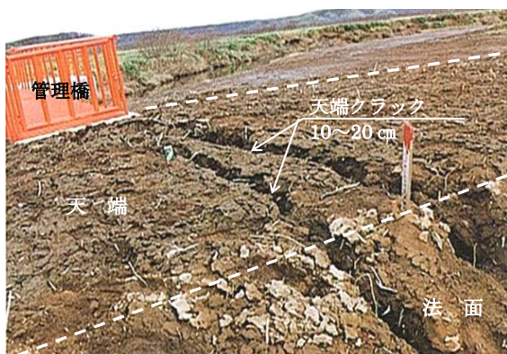
写真-5.2.1 天端の開口クラック
