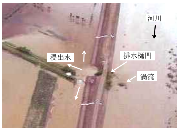
写真-5.2.31 樋門底版部の漏水 28)
