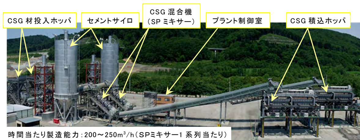
写真-7.2 CSG 製造設備(当別ダム, 2009 年)
