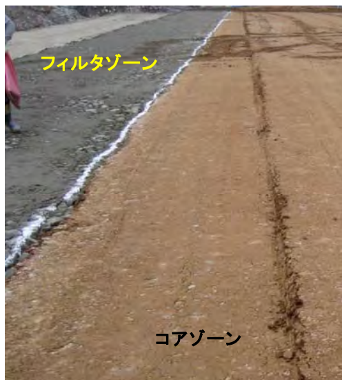
写真-6.3 コア・フィルタ境界部の状況 (著者撮影)
