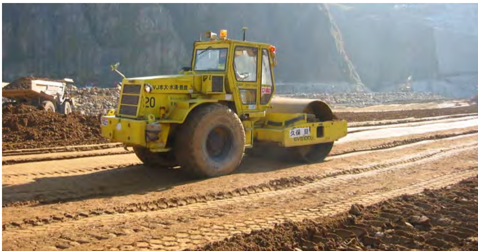
写真-6.1 振動ローラによるコア材の転圧状況(胆沢ダム建設工事, 著者撮影)
