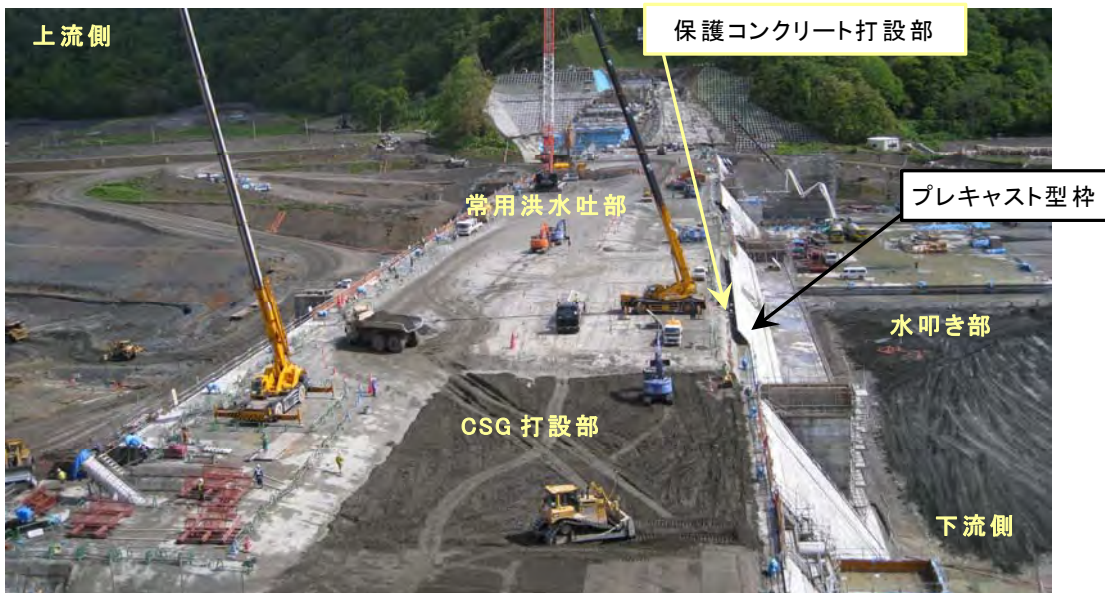
写真-7.9 CSG 打設状況全景(当別ダム, 右岸から撮影, 2010年, 著者撮影)
