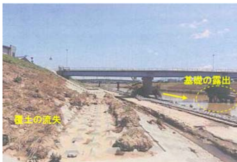
(b) 高水敷上の浸食と橋脚基礎の露出 (1.6k 付近)
