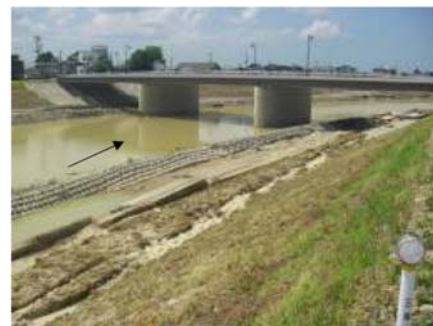
(c) 高水敷の流失と低水護岸の被災 (0.8k 付近)
