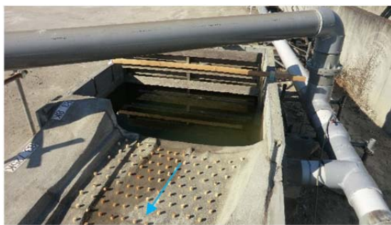
上流端 整水層
