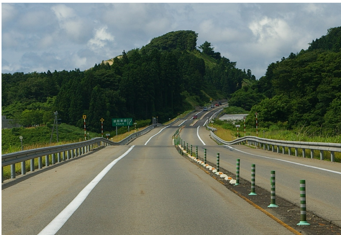
図 1-1 供用後の残留沈下の例（撮影：2014年7月1日）
