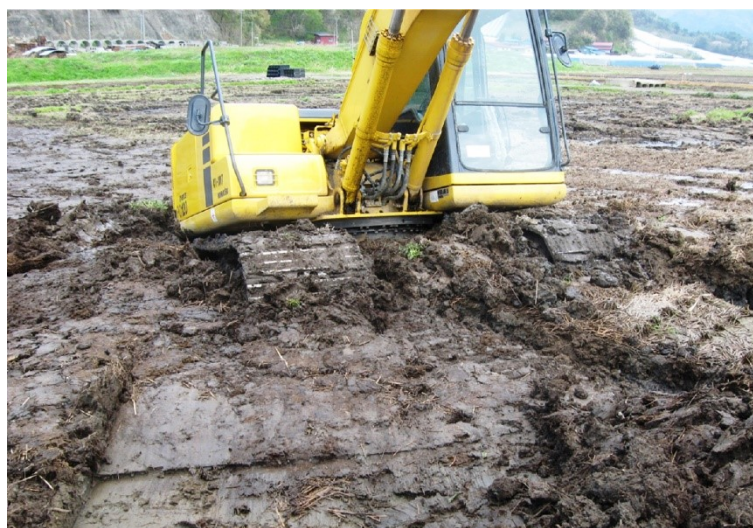
図 2-14 耕土を踏み抜いた建設機械
