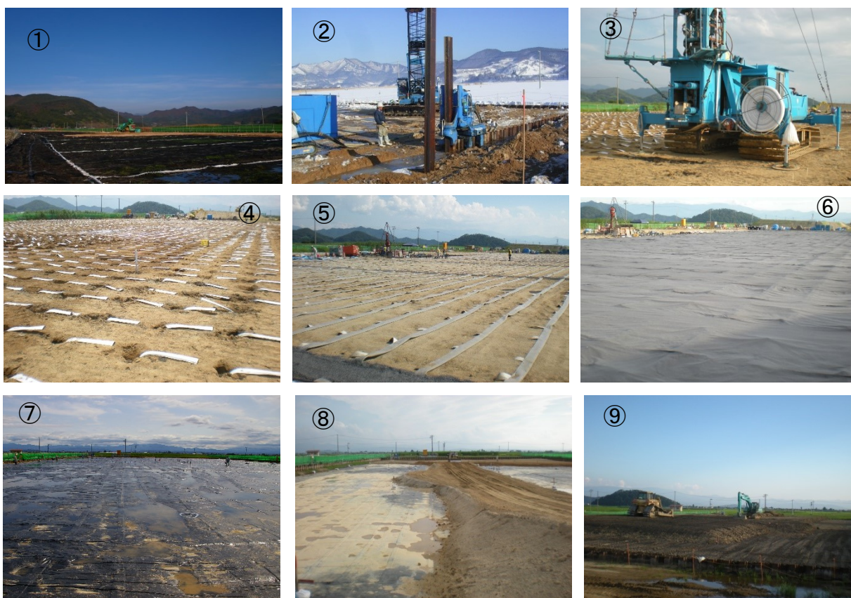
図 4-7 シート式真空圧密工法の施工状況 (①敷網工, ②Area1 矢板打設, ③ドレーン打設, ④鉛直ドレーン, ⑤水平ドレーン, ⑥気密シート, ⑦初期載荷 開始 30 分後, ⑧表層排水工, ⑨盛土)
