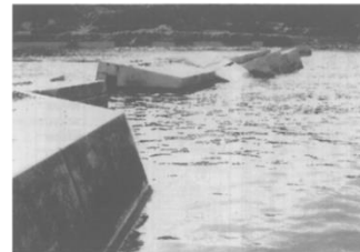
北防波堤の堤体被災状況
