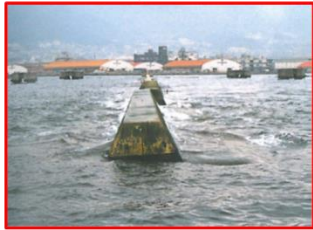
第4防波堤の水没状況
