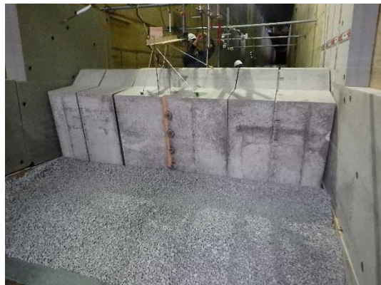
(b) マウンドにめり込み傾いている状況
