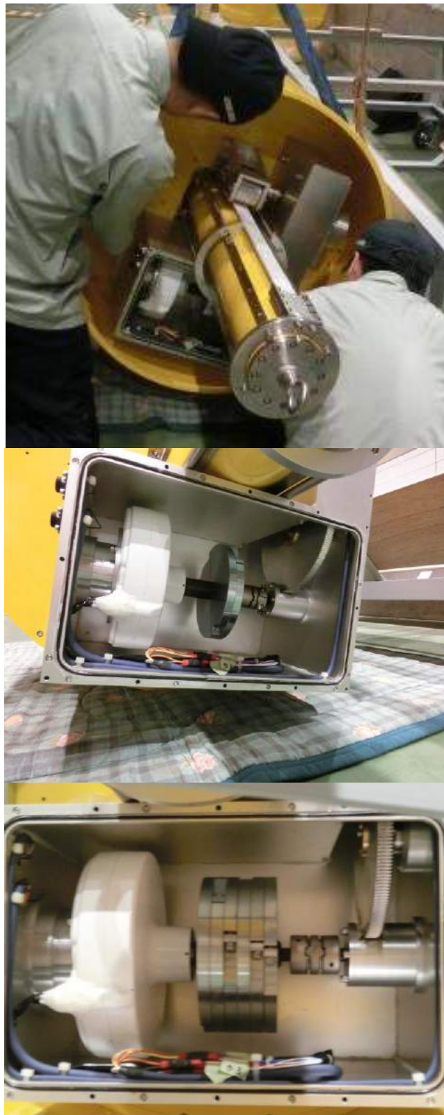
図 3.5 浮体内部の発電機とフライホイール
