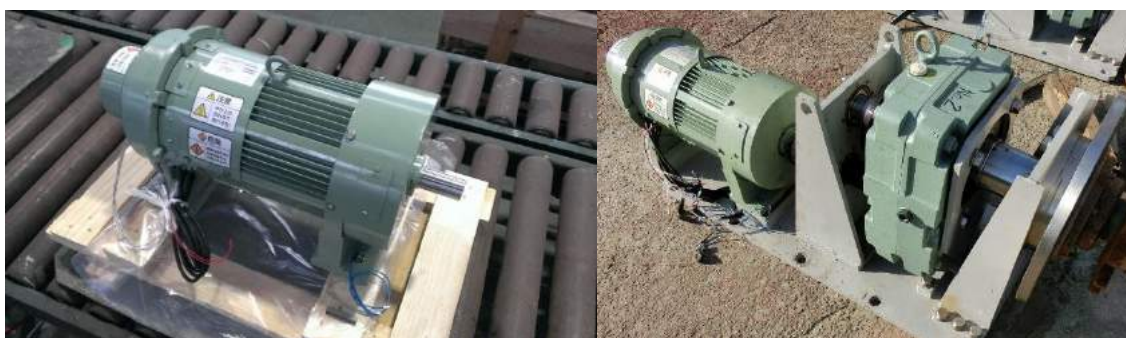
図4.3 10kWモータ発電機および減速機
