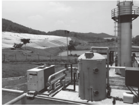
図1 クアラルンプール プキッ・タガー最終処分場のメタン回収設備
