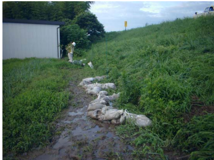
写真 3-2-3 裏のり尻付近の噴砂を伴わない漏水状況(千曲川河川事務所資料)
