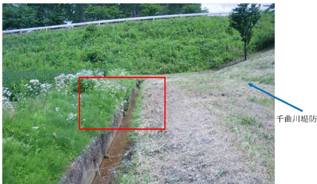
写真 6-4-2 左岸堤防 29.0kp 付近の湧水状況 8) 常時の湧水があり，水は酸化褐色を呈している
