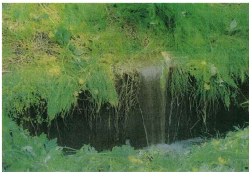
写真 6-4-1 左岸堤防 29.0kp 付近の湧水状況（融雪期） 8)
