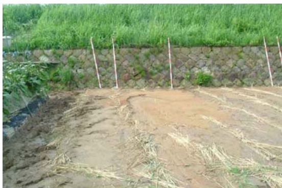
写真 5-1-1 白江地区(左岸 6.6kp 付近)の漏水状況(噴砂)
