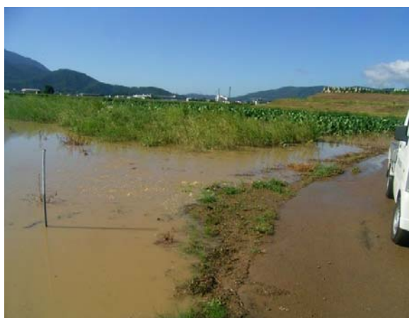
写真 5-2-1 平成 25 年 9 月出水時の漏水状況 10) 堤防から 100m 離れた位置で漏水が発生している。
