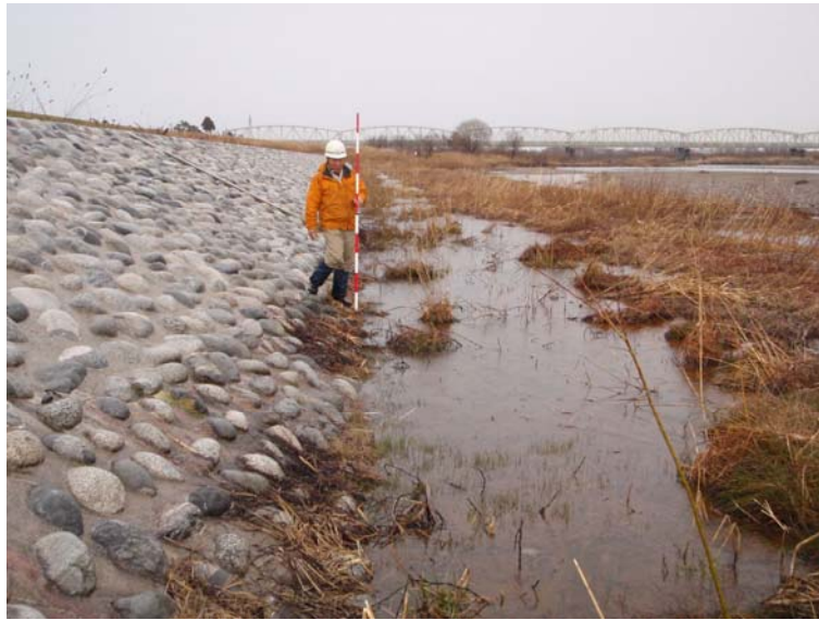
写真 2-2-1 常願寺川左岸 3.5kp 付近の低水護岸部の湧水
