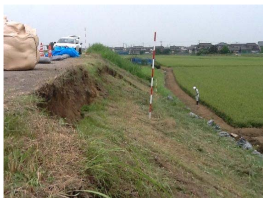
写真5-3-1 右岸8.4kp付近のすべり破壊発生
