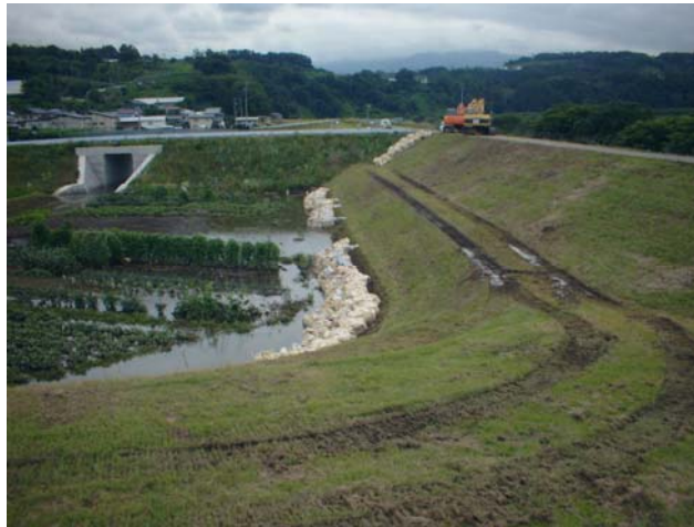
写真 3-2-6 大俣地区の噴砂を伴わない漏水状況(千曲川河川事務所資料)
