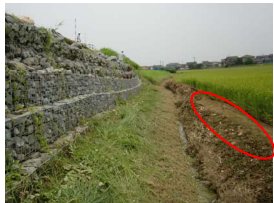
写真5-3-3 右岸 8.4kp の崩壊箇所のり尻部状況
