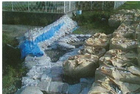
写真 3-2-2 裏のり尻付近の漏水状況
