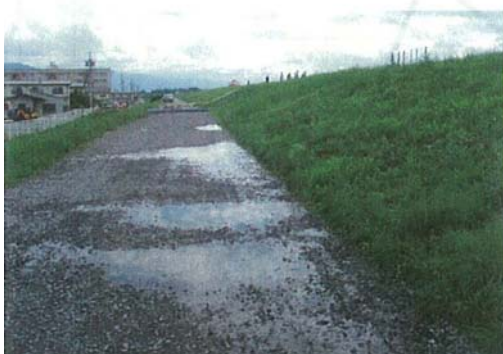
写真 3-2-1 裏のり側の小段の漏水状況
