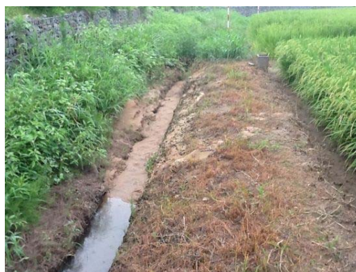
写真5-3-2 右岸8.6kp付近の噴砂状況箇所
