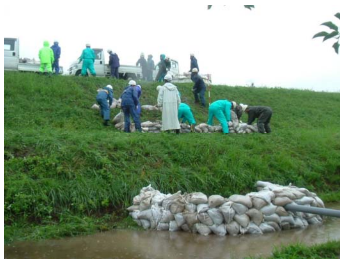
写真 3-2-4 飯田地区の噴砂を伴わない漏水状況(千曲川河川事務所資料)
