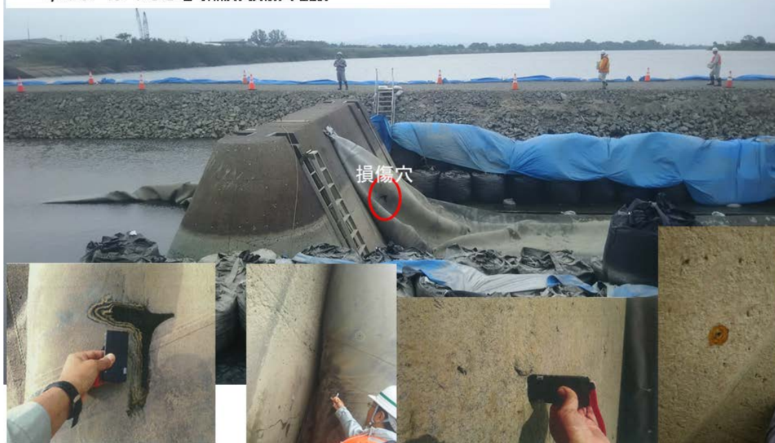
図 2.6.4.1 ゴム堰袋体損傷穴の発生
