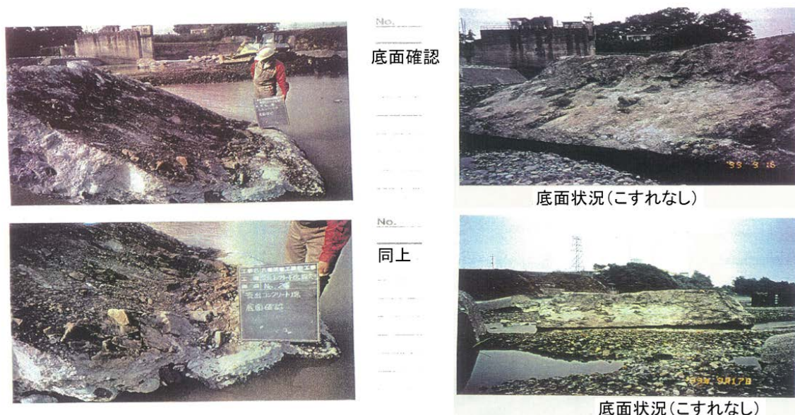
図 2.6.3.2 R 堰 転倒流失した可動堰固定部底面の状態
