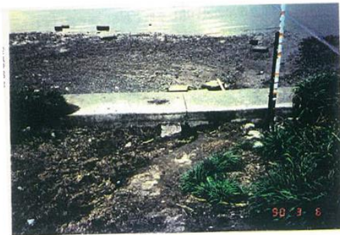
※H元災害ではない
