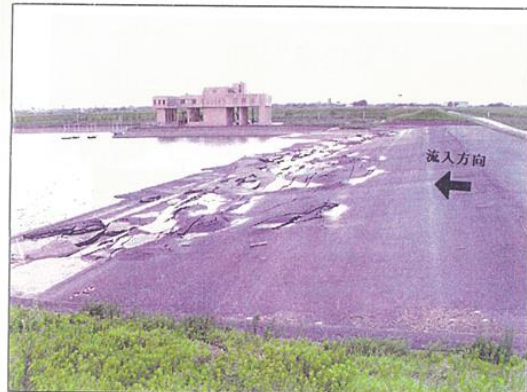
流入堤アスファルトフェーシング被災状況
