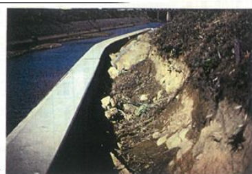
のり肩侵食状況
