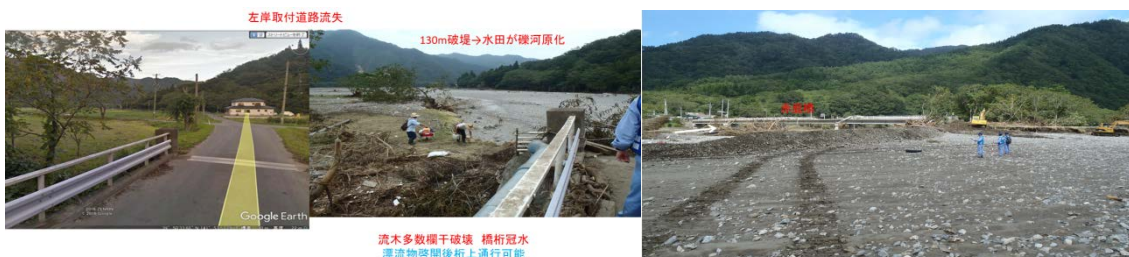
図 3.1.1.8.8 橋台背後と堤内地は被災を受けたが桁・橋台が無事で通行機能を維持
