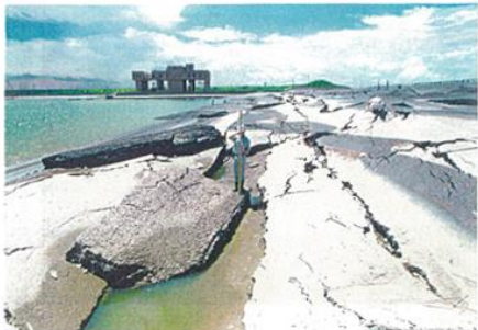
アスファルトフェーシング被災状況
