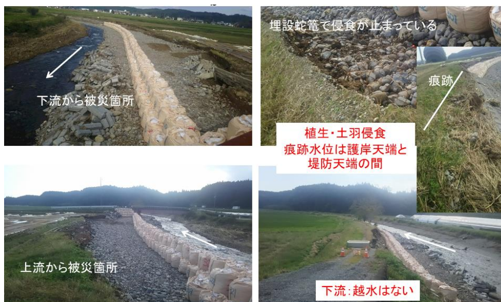
図 2.2.1.6 超過洪水による侵食破堤例（2019 年台風 19 号 栃木県内河川 ( I_b=1/75 )） 2)
