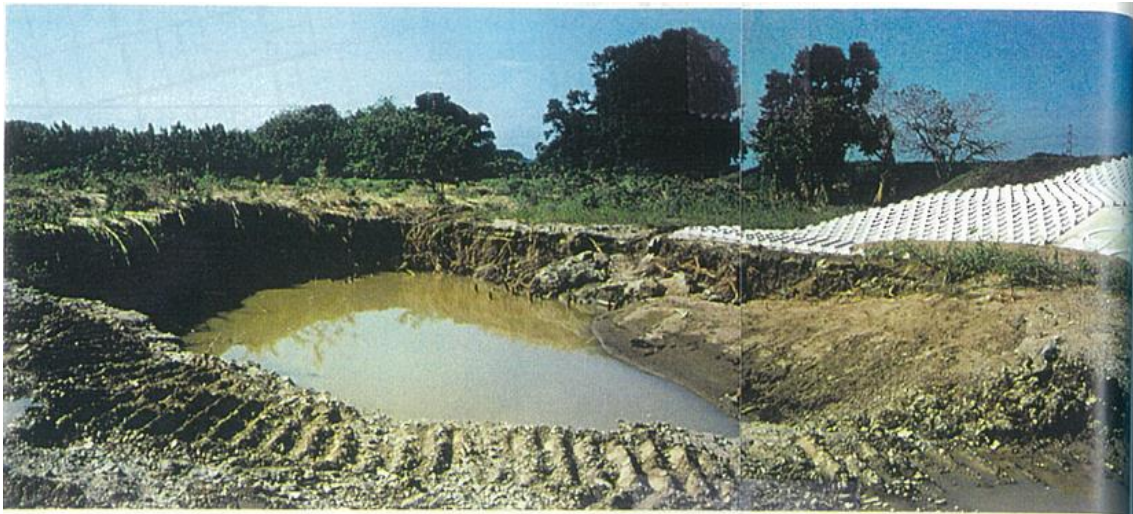
図 2.3.2.17 都幾川 H3 洪水 高水護岸施工端部表のり尻の高水敷洗掘穴
