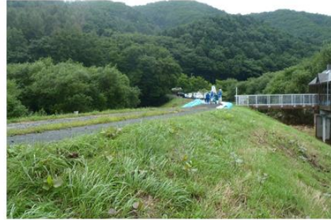
堤防天端高が下がっている区間で越水発生
