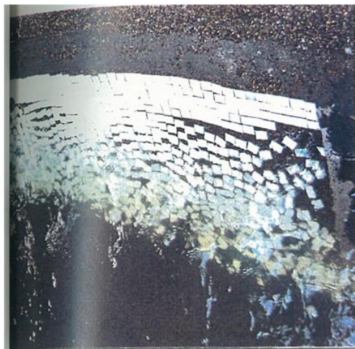
根入れ不足護岸の破壊状況
