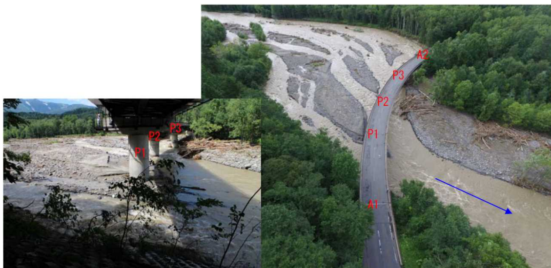
図 2.6.5.3 高原大橋被災後斜め写真 3)
