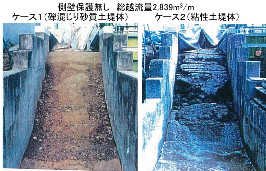
図 2.5.3.11 通水後のり面侵食状況比較 (ケース 1 とケース 2)
