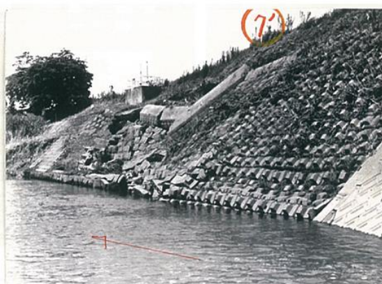
間知ブロック積み護岸(胴込めが不足している場合)の被災
