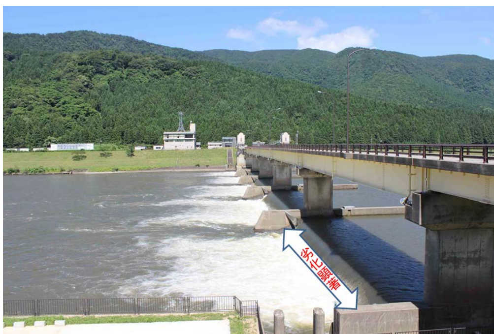
図 2.6.4.9 複数スパンのゴム堰 劣化の差
