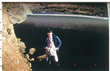
のり肩侵食状況
