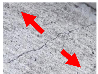
写真-2 土間コンクリートのクラック
