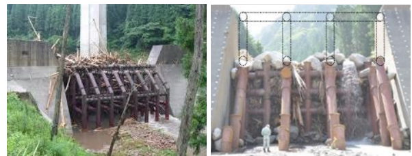
(a) 流木捕捉時 (b) 一部破損した堰堤
