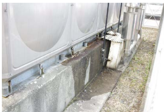
(b) タンク下部での漏水 1
