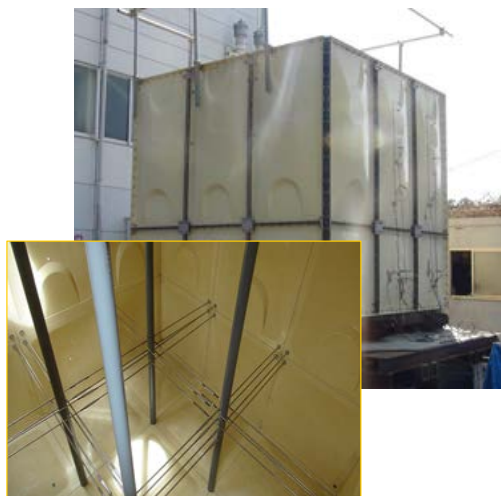
写真-4.1.3 FRP製パネルタンク (FRP タンク)
