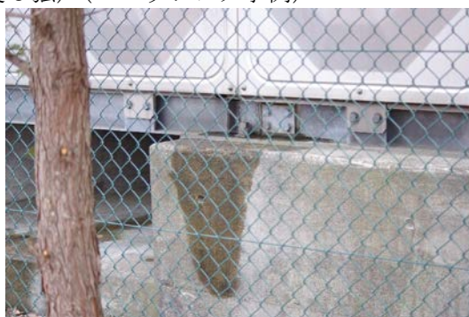
(b) タンク下部での漏水 2
