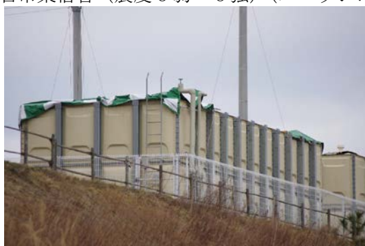
写真-2.2.8 FRP パネルタンク被害 宮城県仙台市某商業施設（震度6弱～6強）（スロッシング事例）
