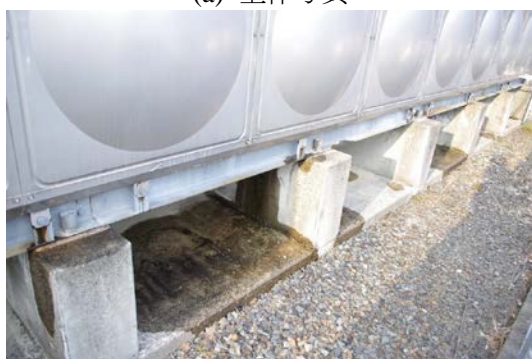
(c) タンク下部での漏水 2
