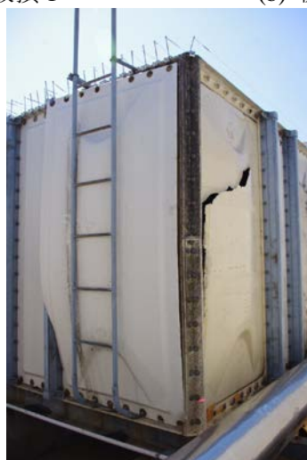
(d) 側板パネルの破損 4
