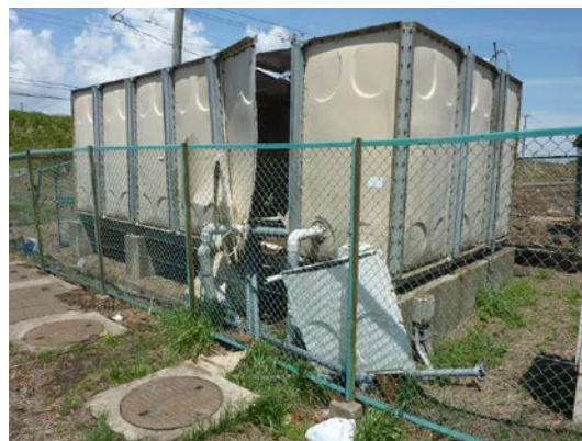
(b) 側板パネルの破損
