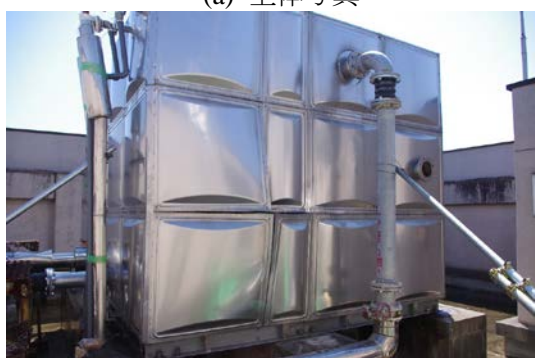
(c) 側板下部の膨らみ
