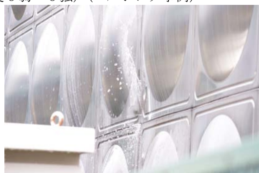
(b) パネル接合部の漏水
