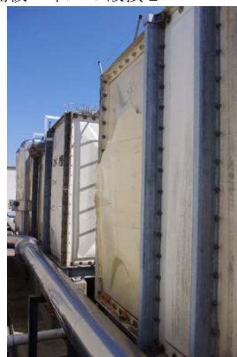
(e) 側板パネルの破損 5
