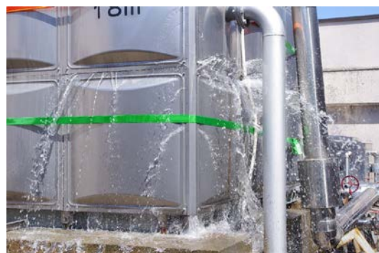
(b) パネル接合部から漏水
