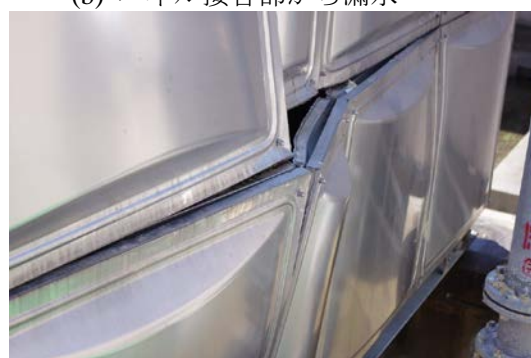
(d) パネル接合部の破損
