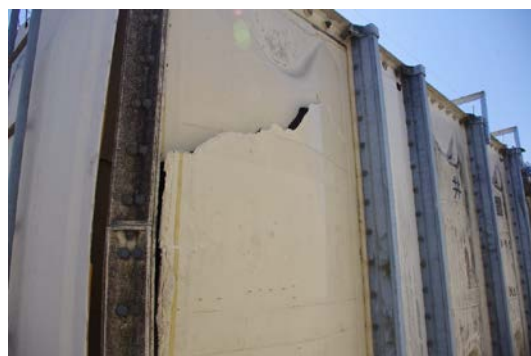
(b) 側板パネルの破損 2
