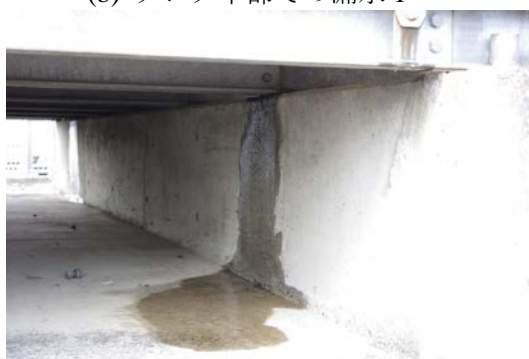
(d) タンク下部での漏水 3
