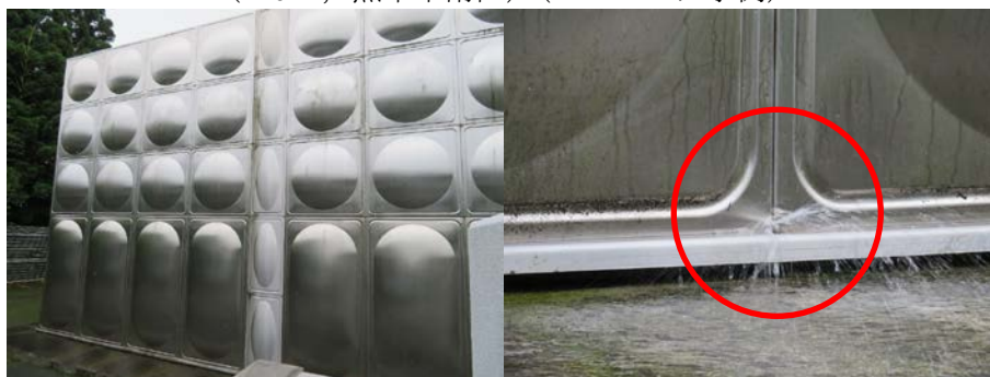
写真-2.1.2 下部パネル溶接部の損傷例（熊本県菊池郡） （バルジング事例）
