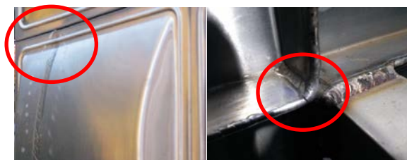
(a) 水漏れの様子 (b) 溶接部のクラック (1 段目節点番号 12 付近) (2 段目節点番号 34 付近)
