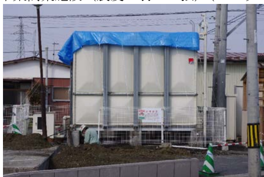
写真-2.2.9 FRP パネルタンク被害 宮城県大崎市某マンション（震度6強）（スロッシング事例）
