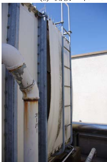
(c) 側板パネルの破損 3
