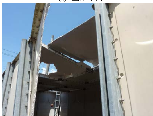
(c) 天井パネルの破損
