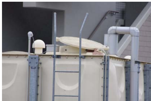
写真-2.2.12 FRP パネルタンク被害 宮城県名取市某ホテル（震度6強）（スロッシング事例）
