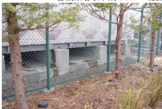
(a) タンク下部での漏水 1
