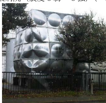
写真-2.2.3 ステンレスパネルタンク被害 茨城県つくば市某研究施設（震度6弱）
