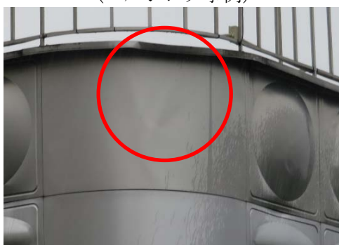
(a) 隅角部上部の損傷
