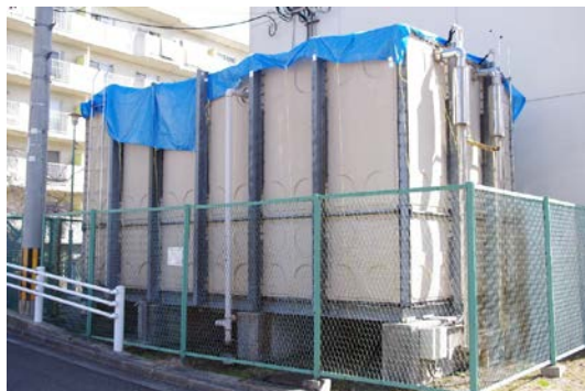
写真-2.2.7 FRP パネルタンク被害 宮城県仙台市某宿舎（震度6弱～6強）（スロッシング事例）
