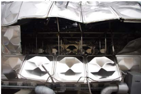
(c) 側板パネルの破損 1
