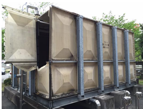
写真-7.1.1 隅角部上部側ならびに天井部が破損した事例 (FRP タンク) (熊本市南区)
