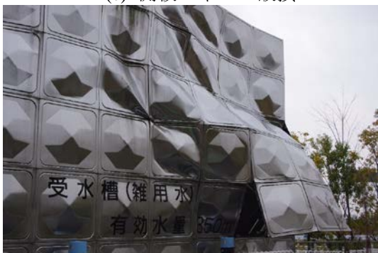
(e) 側板パネルの破損 2
