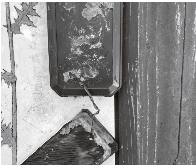
図16 太陽電池が剥がれた状態
