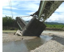
図-1 大規模被害の例 (JR 磐越西線濁川橋梁)
