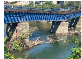
図-2 中規模被害の例 (JR 五能線中村川橋梁)
