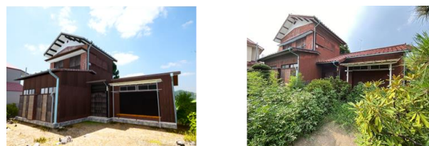
図-2 空き家の例
