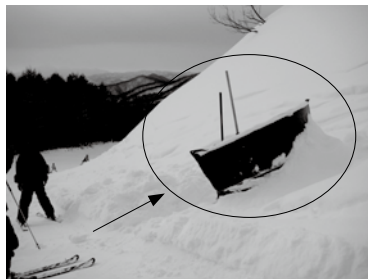
写真 18 給水栓の保護マット
